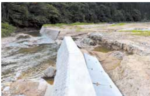
氾濫で堤防が決壊（中五反沢）
